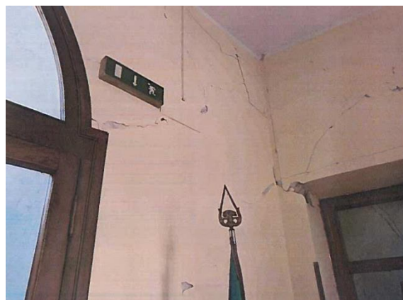
Lesioni all'interno dell'edificio
