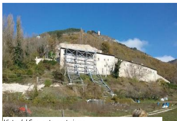
Vista del Convento post sisma
